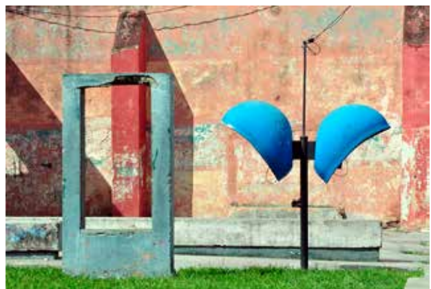
Parque en Regla. Punto referencial en la localidad y ejemplo de deterioro constructivo.
