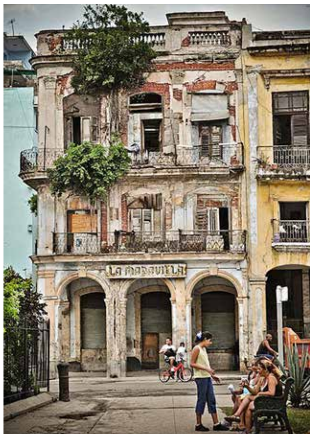
Edificio en ruinas en la esquina de Villegas y Amargura.
